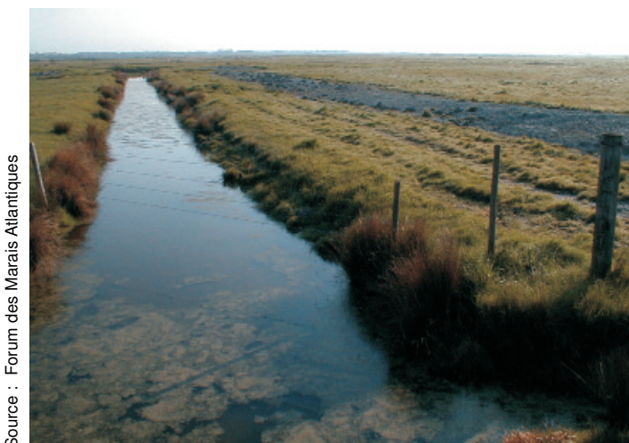
Fig.26 - Le dépôt de la vase extraite se fait contre ou par-dessus l'ancien bourrelet.
