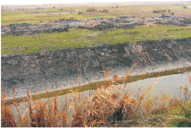
Fig.8 - Fossé curé "à blanc", instable dans le temps.
