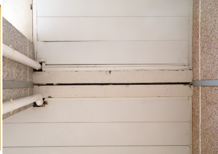
Photo 6 malfaçons dans les plafonds utilisées par des martinets (Haut Fangu)
