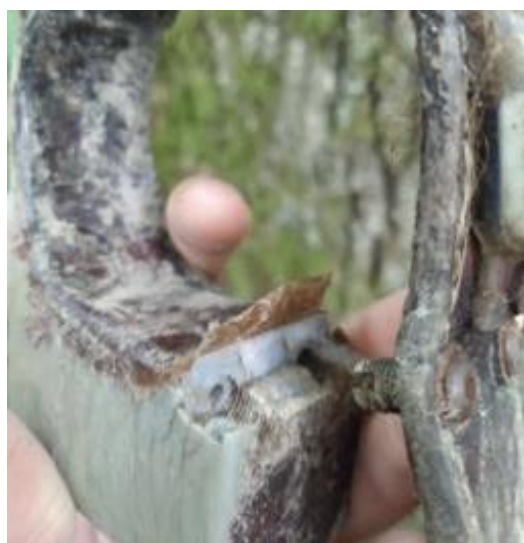
Figure 16. Collier cassé récupéré après sept mois de pose
