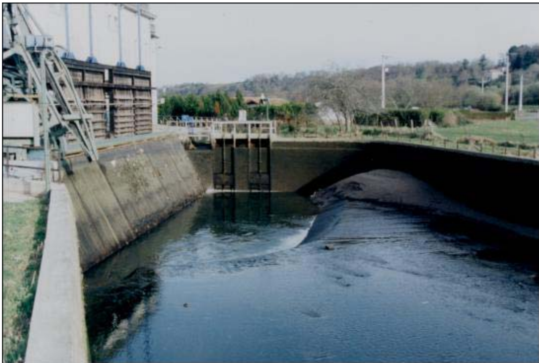
Photo 14 : Zone usine (vue amont) lors de la vidange du canal d'amenée. On distingue au fond le clapet de surface (à gauche en bout de canal) et les deux vannes de fond. Celle de droite a été utilisée en tant qu'exutoire de dévalaison (photo F. Travade).
